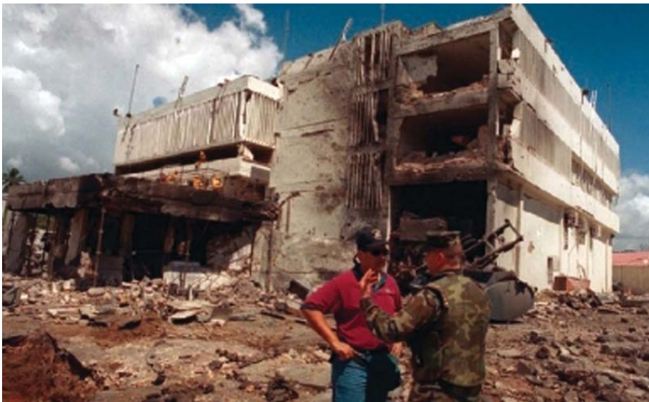
Zdj. 7. Budynek ambasady w Tanzanii po ataku bombowym dokonany 7 sierpnia 1998 r.
